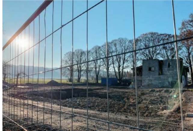
Ein Bauzaun kündigt das neue Vorhaben an: Hier soll das neue Domizil des Gnadenhofes Katzentraum entstehen.
